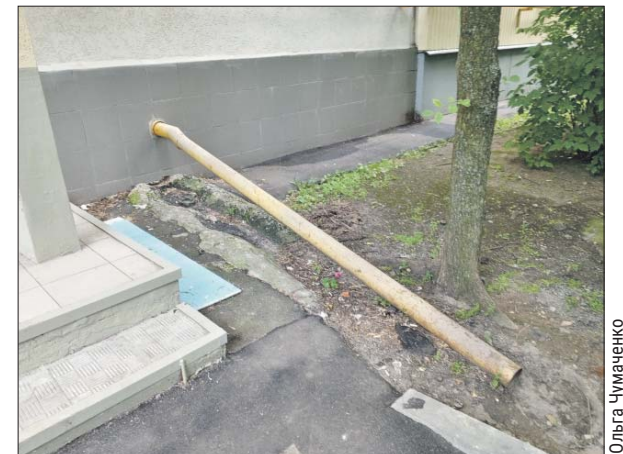
Сейчас вода отводится на газон
