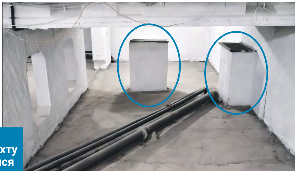
Вентиляционные шахты на чердаках должны быть закрыты решётками
