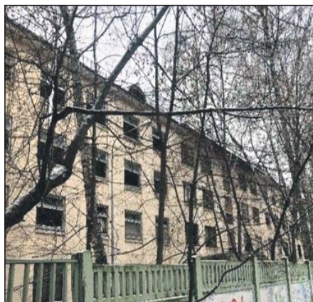
Дом находился в ветхом состоянии
