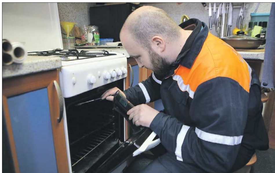
С помощью течеуловителя Иван Давыдов проверил всё газовое оборудование на кухне
