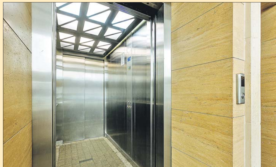
В домах установлены грузовые и пассажирские лифты
